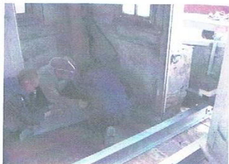
In der Turmstube, aus der heraus die langen Metallteile später wieder die Balkone halten sollen, ziehen drei Maurer die Träger nach innen. Über ihnen marode Turmfenster; draußen die anderen Maurer.
