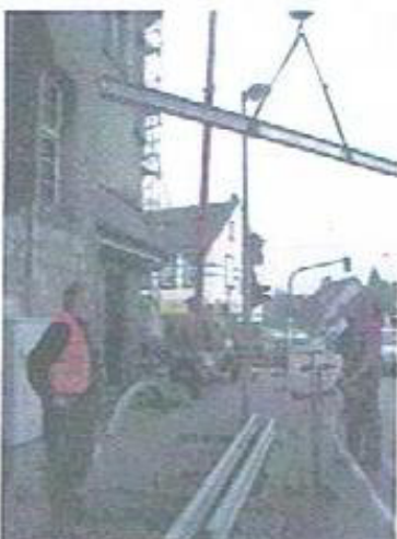
Sorgsam überwacht Josef Palmen (l) wie Träger um Träger vom Bürgersteig der Hafelsstraße aus von Dachdeckermeister Helmut Witt (r) in die Höhe zur Turmkammer „geschwebt“ wird.
